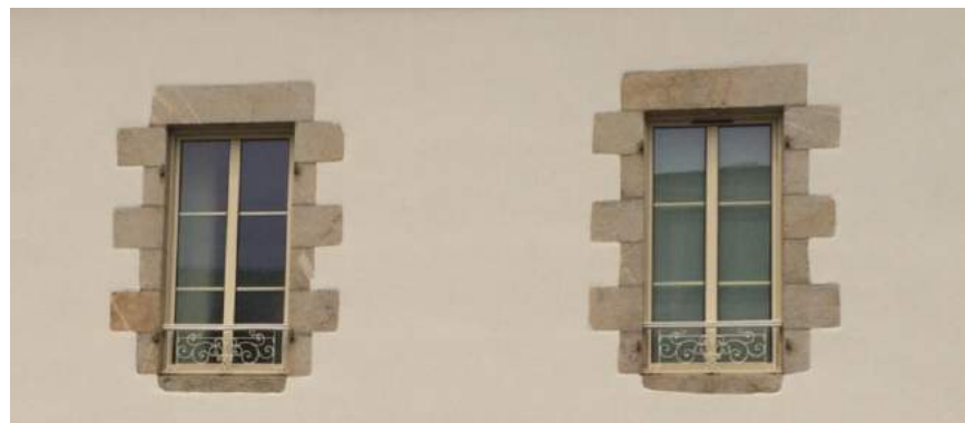
La disparition des persiennes appauvrit la façade
