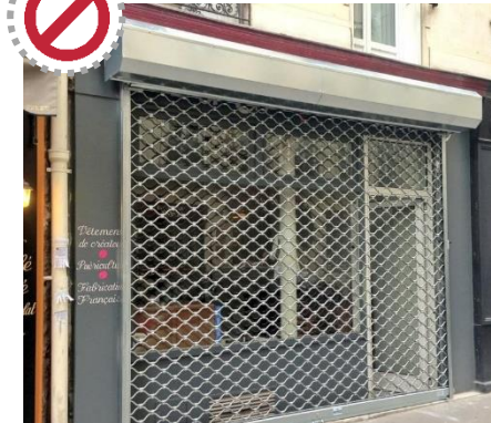
● non intégration du coffre du volet : le coffre est en débord par rapport à la façade
